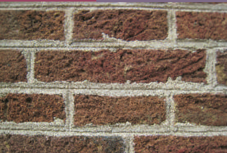
Door het schoonstralen zijn stukjes van de baksteen verdwenen en is de steen verzwakt
