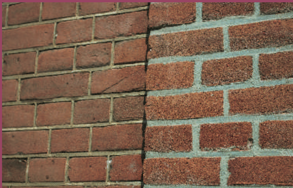
De voegen van deze gevel werden veel te breed uitgeslepen waardoor er na het voegen een dikke, grove voeg is ontstaan (rechts)
