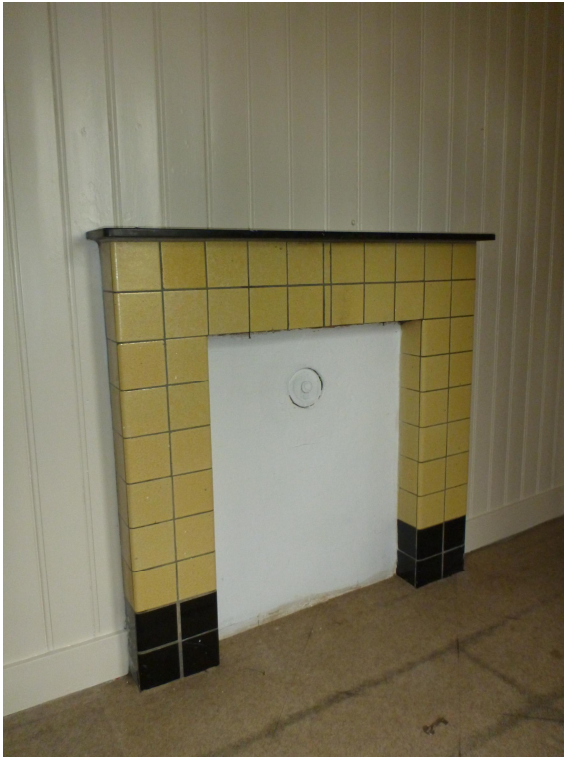
Afb. 25. Een van de stookplaatsen op zolder
