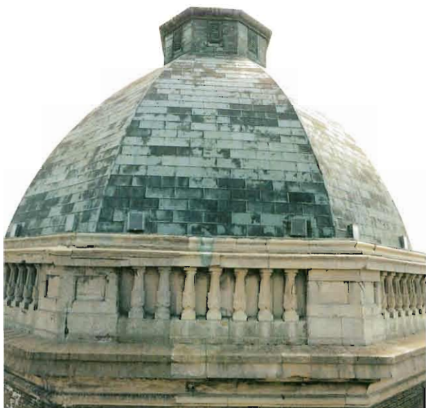
Scheuren in de natuurstenen balustrade onder de koepel van de watertoren in 1988 (foto, Flying Camera Eindhoven).
