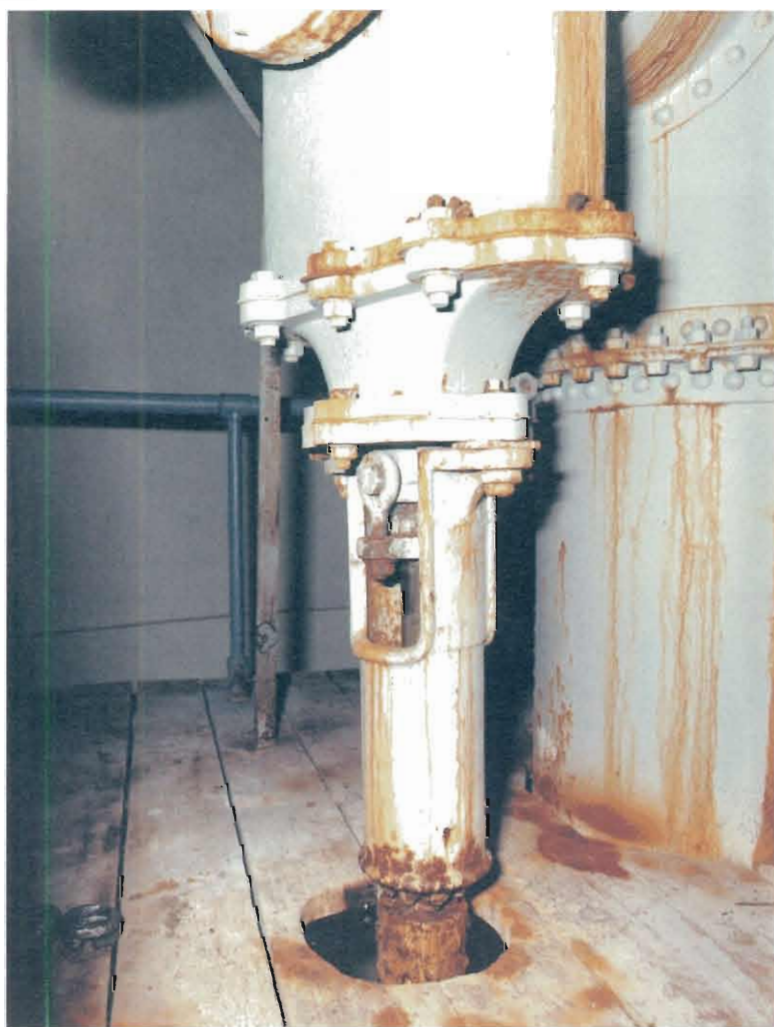
Ernstige roestvorming in het interieur van de watertoren (foto 1988, verzameling DWL).
