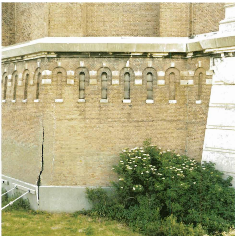
Op sommige plaatsen raakte de buitenmuur los van de binnenmuur van de watertoren (foto 1988, Flying Camera Eindhoven).
