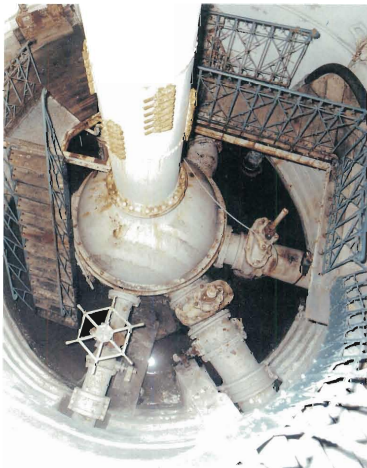
Standpijp met verdeelkast in de watertoren in 1988 (foto, verzameling DWL)
