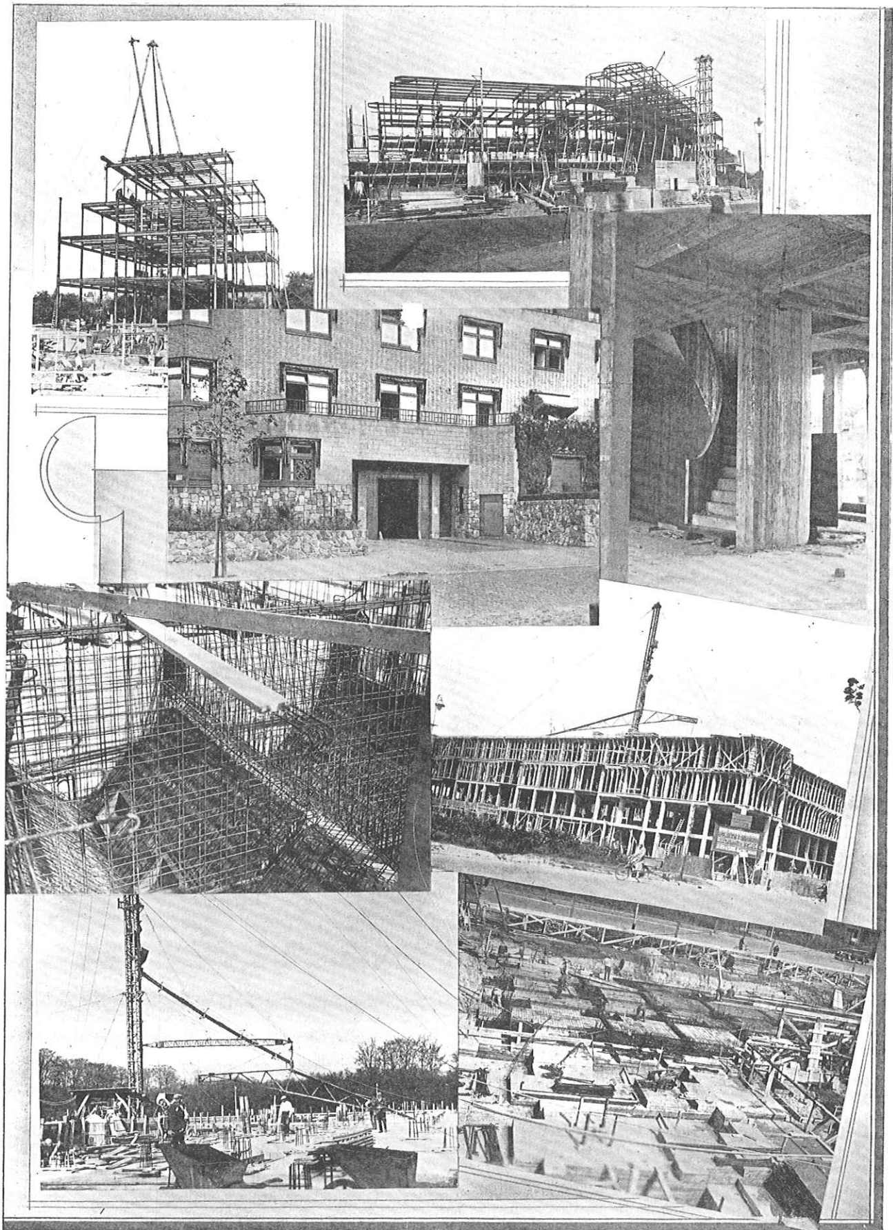
1e rij l. en r. IJzerconstructie „Cats' Heuvel.” 2e „ l. Ingang „Cats' Heuvel. r. Betontrap „Duinwijk.”
