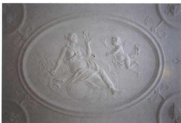
Het stucplafond in het voorhuis, eerste verdieping.
